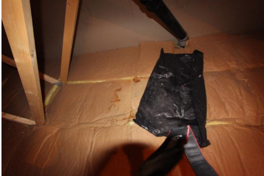
Fuktmerker på isolasjon.
