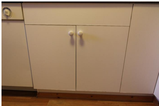
Skade på fronter/dører.
