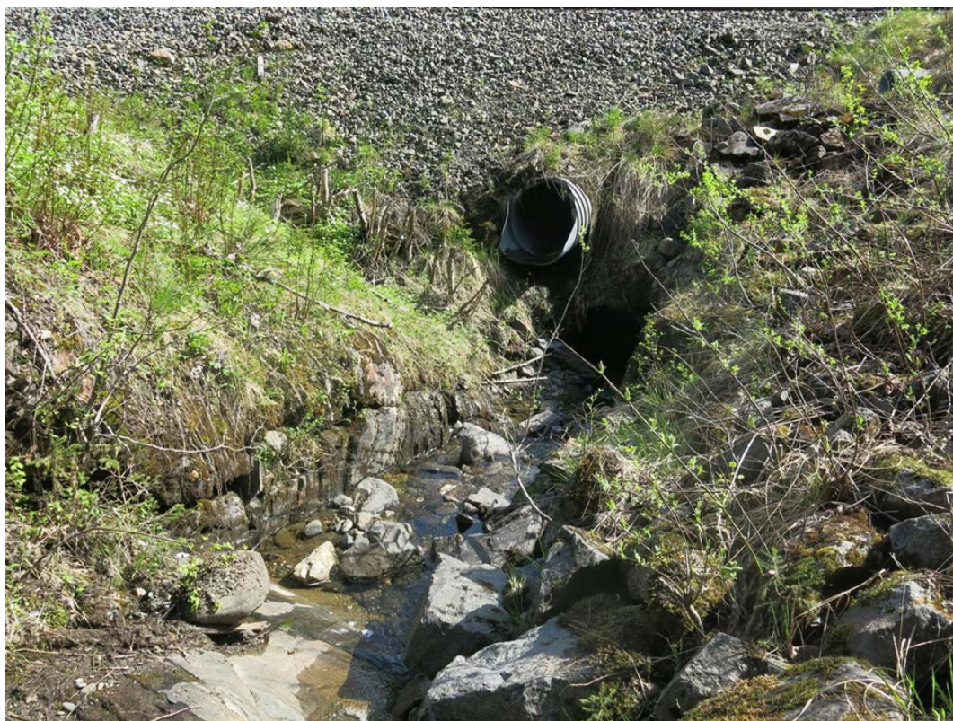
Figur 3.16 Stikkrenne for Nordlandsbanen på strekningen mellom Svenningelv og Lien.
