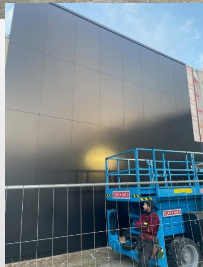
Prosjekt Vannlekkasje GBU - Vegset
